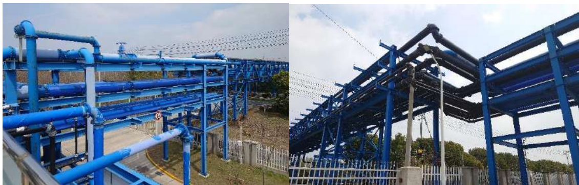
图 2 园区工业污水“一企一管”收集管网
