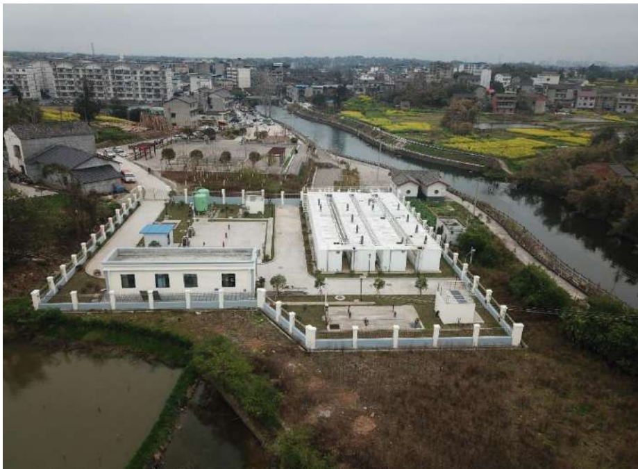
隆昌市龙市镇污水处理场站 处理规模：800/吨天
