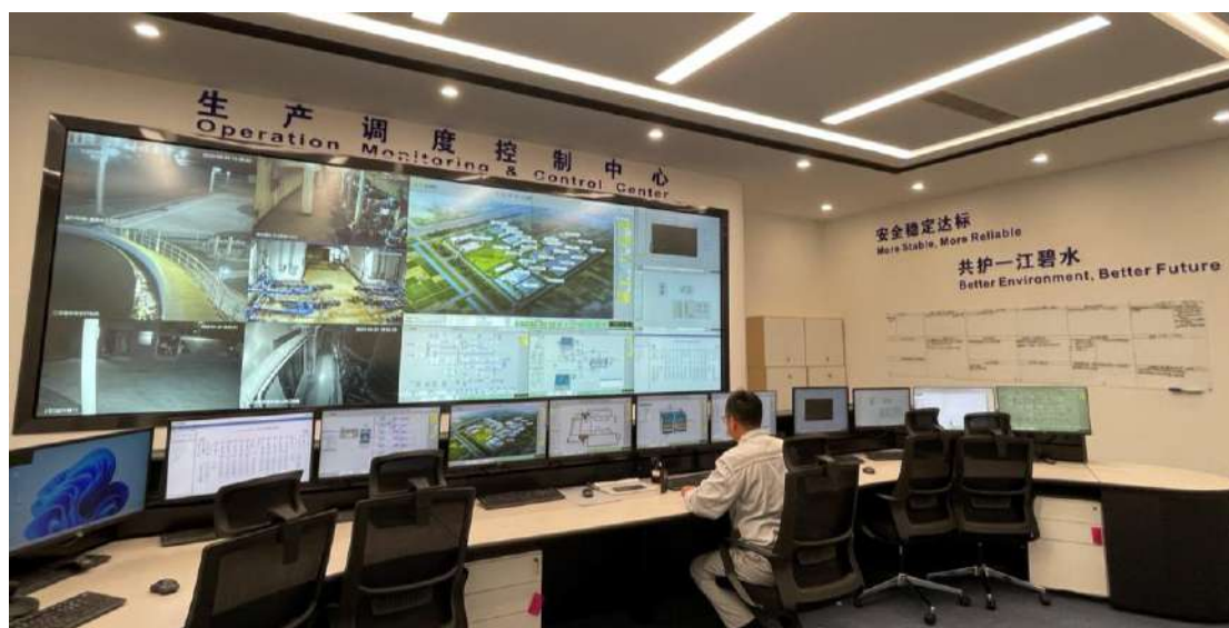
图 5 污水处理厂中控室实景
