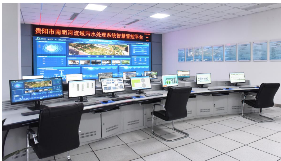
图 10 贵阳市南明河流域污水处理系统智慧管控平台
