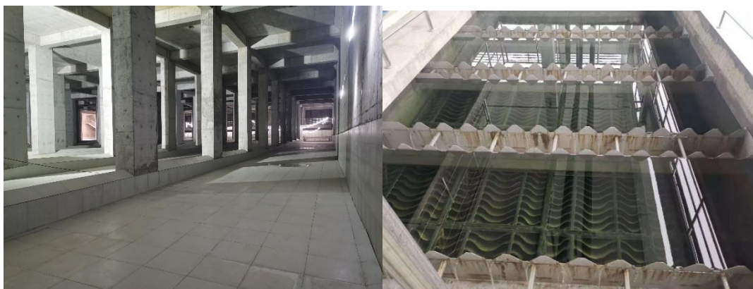
图3 调蓄池（左）及加砂高效沉淀池出水（右）
