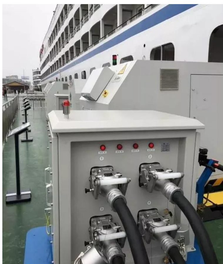
图 6-15 三峡坝区岸电实验区岸电设施
