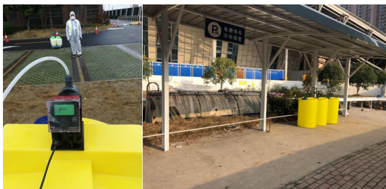
图 5-19 方舱医院污水处理设施的加氯消毒现场图片
