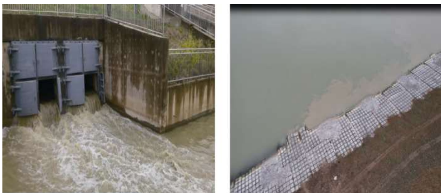
图 2-2 雨水泵站污水直排入河形成河面污染带
