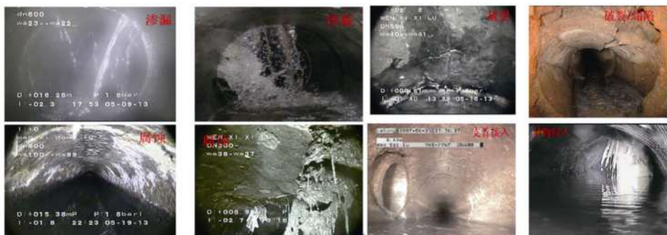
图 5-10 市政排水管网结构性缺陷
