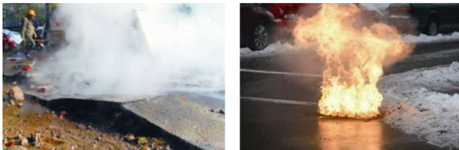
图 2-7 排水管道气体爆炸
