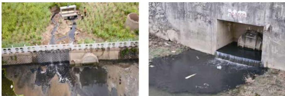
图 2-3 截污闸污水溢流入河
