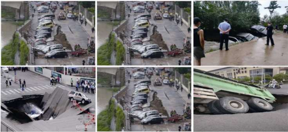
图 5-8 城市路面塌陷
