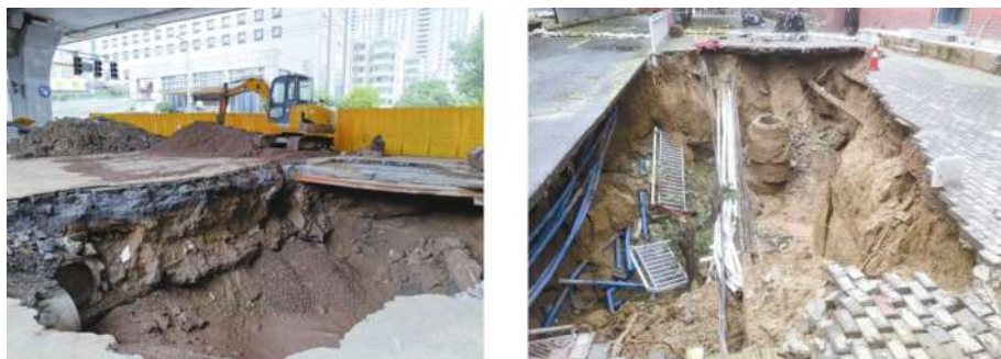
(a)郑州市农业路与经二路交叉口道路塌陷现场 (b)郑州六厂前街塌陷现场，快车道只剩一层沥青路面
